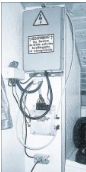
Bild 4: Fernbedienter Tuner mit Schaltbox und Potentialausgleichsschiene, auf der alle Radials enden
